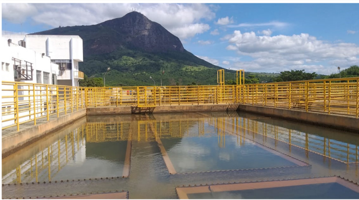
Figura 6: Tanques de decantação/sedimentação. Fonte: Os autores (2020).
