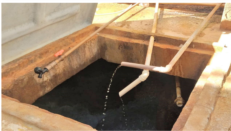
Figura 8: Tanque de contato (cloração e fluoretação). Fonte: Os autores (2020).
