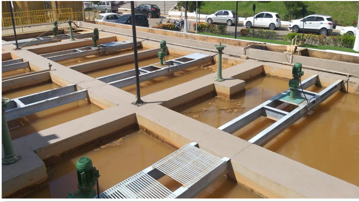
Figura 5: Tanques de floculação/coagulação. Fonte: Os autores (2020).
